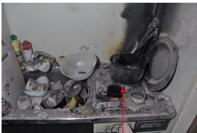
台所の状況 クッキングヒーター
