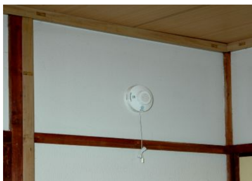
住宅用火災警報器の設置状
