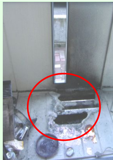
床面の樹脂が焼損し、周囲が焦けている状況。（赤丸部分）
