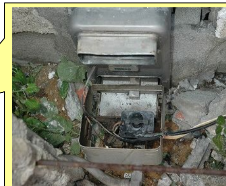
ボックス内の焼損状況
