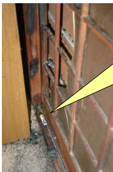
出火箇所の状況
