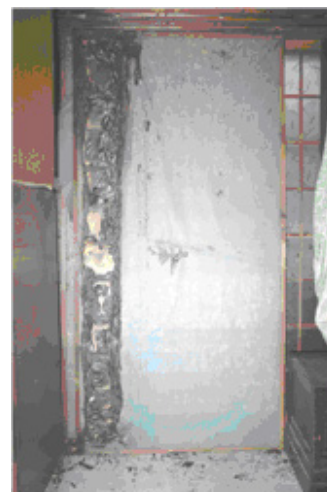
ふすまの焼損状況
