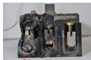
L2 N L1 漏電遮断器一次側接続端子の状況
