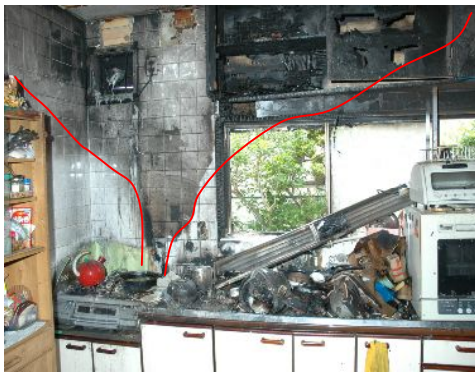
コンロから上方にかけて燃え広がり、天井付近の吊戸棚が焼損している。
