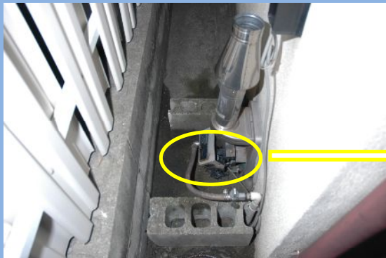
焼損した風呂釜
