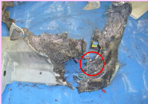
ふたの部分を除去した温水洗浄便座の状況
