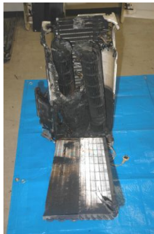
エアコン内部の焼損状況
