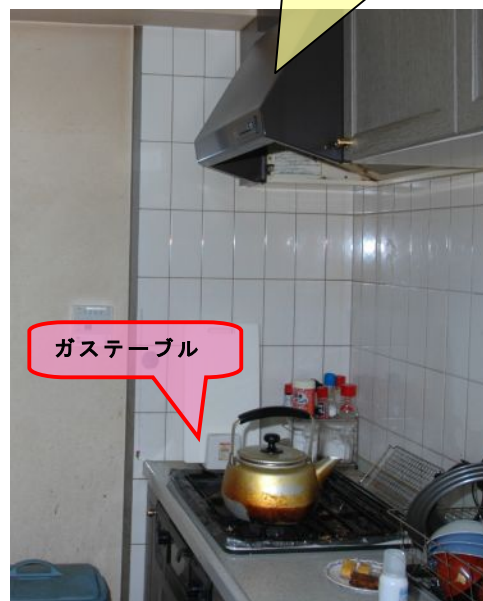
焼損した換気扇フィルター
